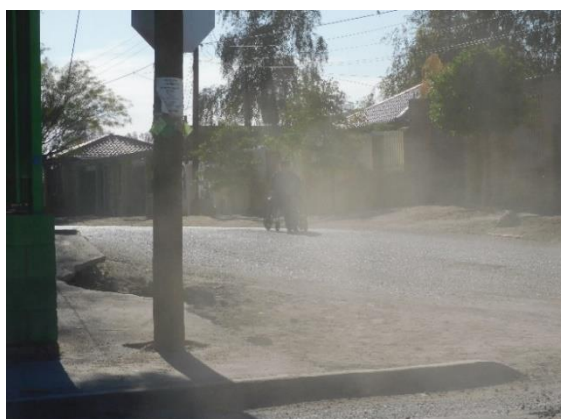
Figura 51. Intersección C. Bernardo Reyes y Av. industriales, rampas peatonales inexistentes, vialidad y banqueta en condiciones deplorables, persona en silla de ruedas transitando por medio de la calle. (Ruiz, 2021)
