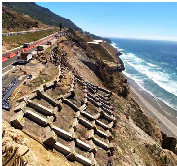
Figura 7.78. Sistema de anclaje en kilómetro 92+500, de la Bahía Salsipuedes, visita de campo No. 7.
