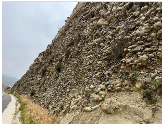
Figura 8.14. Talud del kilómetro 92+450 de la Bahía Salsipuedes, donde se aprecian aluviones sobre una matriz de arenosa compactada (arenisca).
