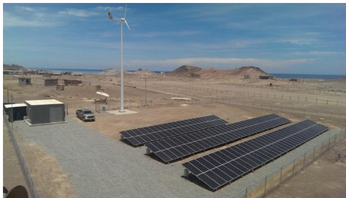
Fig. 5. Fotografía de la microrred de Puertecitos.
