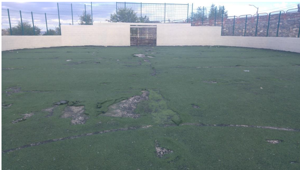
Ilustración 13: Deterioro pasto sintético cancha de fútbol
