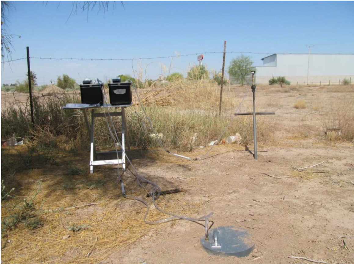
Figura 10. Vista de la instalación en campo del equipo de medición de gas Radón.
