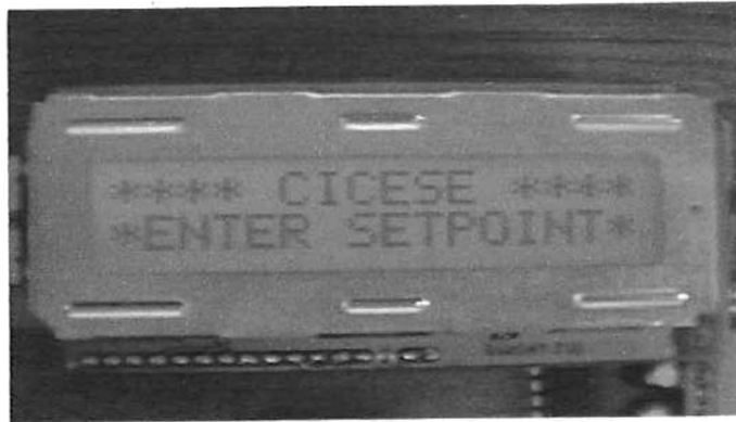
Figura 56. Pantalla de inicio del controlador de temperatura.
